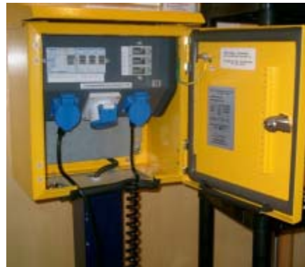
Stromtankstelle 3phasig mit Zählern
