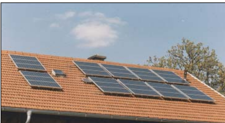
3,3 kW Anlage auf dem Dach, Solar Energie Werk Erlangen n
