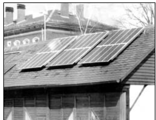
1,1 kW Anlage, Solarmobilverein Erlangen
