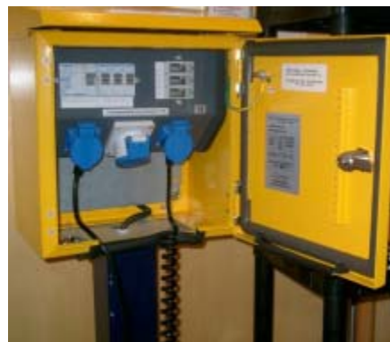
Stromtankstelle 3phasig mit Zählern
